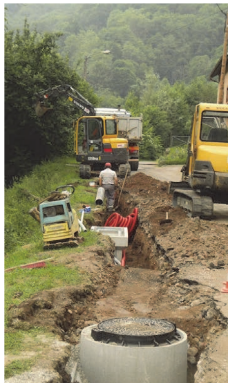
Pose d'un réseau d'assainissement route de la Hingrie avec enfouissement du réseau câblé et de l'éclairage public
