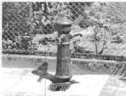
Point d'eau potable
