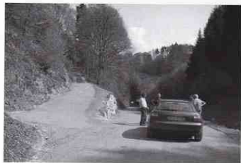
Aménagement de l'accès de la ferme de la Rochette par la construction d'un mur de soutènement
