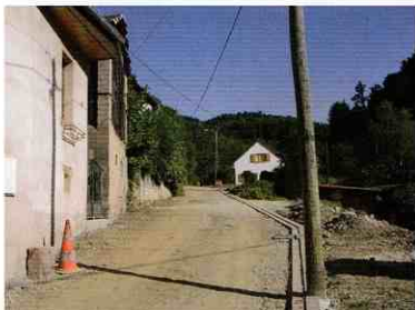
Rénovation de la rue de Pierreusegoutte avec assainissement, enfouissement des réseaux et la pose prochaine de candélabres
